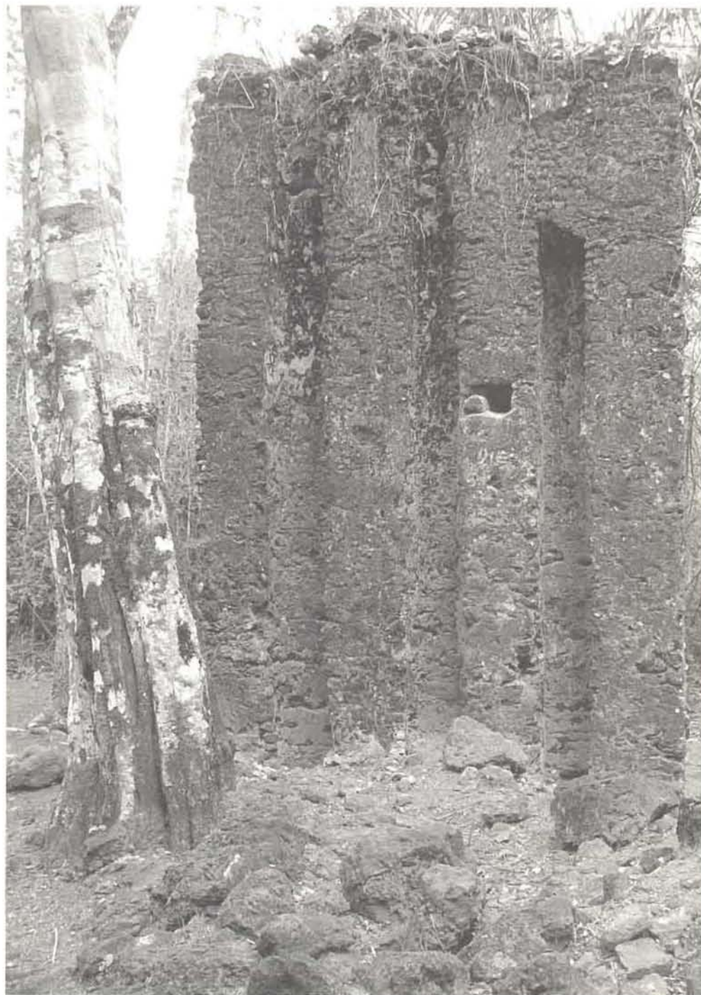
► Figura 27. Marcas deixadas nas paredes que permaneceram em pé, pelos esteios incrustados em seu interior.
